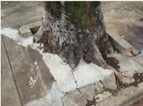
Figura 83. Figura ilustrando a abertura permeável insuficiente e apresentando algumas de suas áreas impermeabilizadas com cimento.
