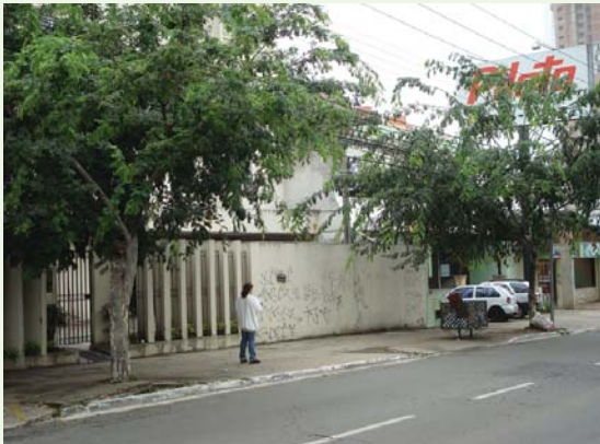
Figura 86. Árvores plantadas sob a rede elétrica de baixa e alta tensão apresentando copa em conflito com a fiação.
