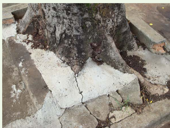
Figura 103. Exemplo de calçada com plantio em abertura permeável insuficiente. Nota-se o início de rachaduras na calçada.
