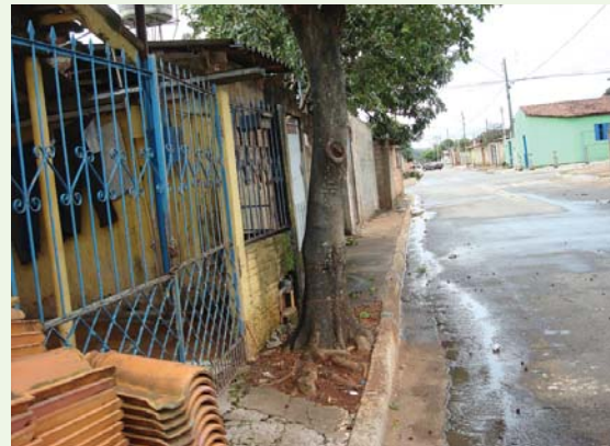
Figura 89. Problemas de danificação de calçada e conflitos com o muro e o hidrômetro provocados pelo plantio inadequado de árvore da espécie saboneteira - Sapindus saponaria em calçada inferior a 1,00 metro.
