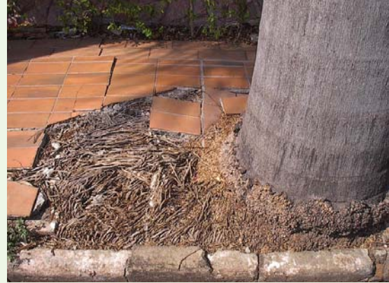
Figura 92. A imagem mostra o levantamento de calçada provocado pela falta de abertura permeável adequada para a palmeira.
