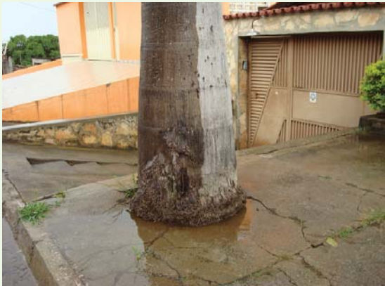
Figura 91. Imagem mostrando a inexistência total de abertura permeável desta palmeira. Nota-se que a calçada começa a apresentar sinais de rachaduras.
