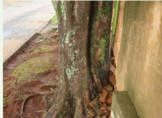
Figura 84. A imagem apresenta um plantio totalmente inadequado, onde o tronco de uma árvore de grande porte se encontra próxima ao muro da edificação, causando rachaduras no muro, conflito com o hidrômetro e problemas na calçada devido ao crescimento de raízes superficiais.
